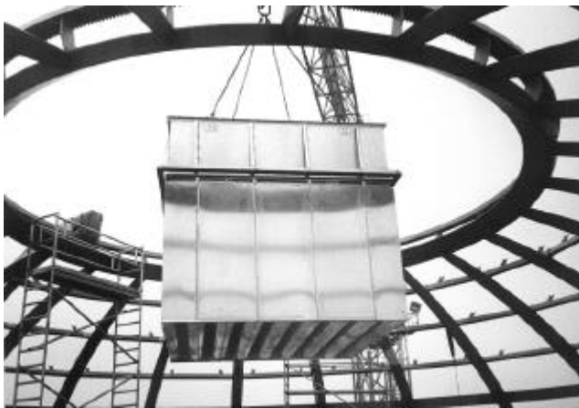
Bild 5: Abluftschalldämpfer in der Kuppel
