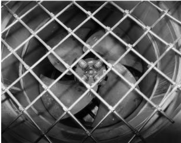
Bild 4: Geräuschoptimierter Abluftventilator im Technikonus
